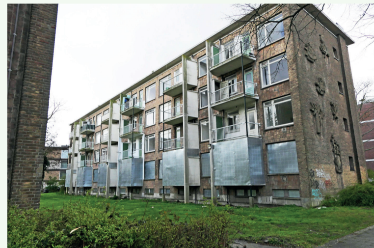
Een dichtgetimmerd flat van het MeLeCo complex aan de Leggelostraat
